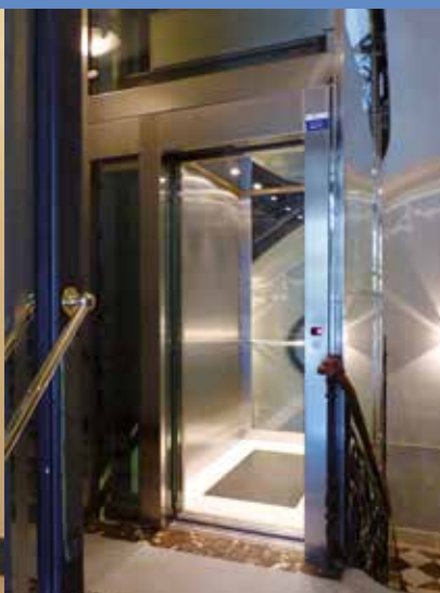
Sustitución parcial. Máquina y variador de frecuencia.
